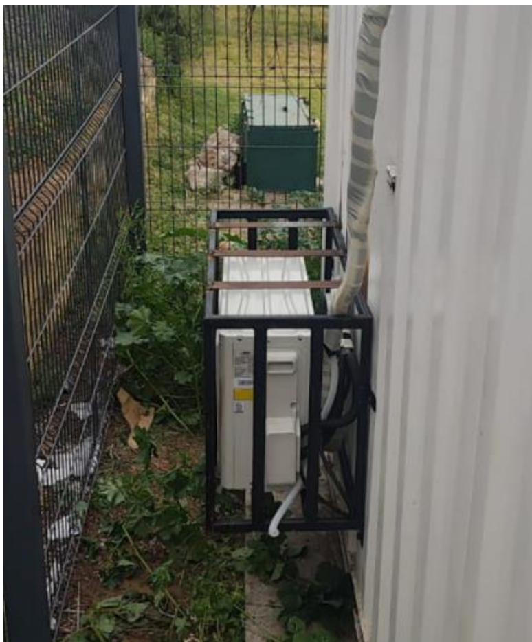
Imagen N°2: Imagen de referencia estructura para aire acondicionado en estación de Monitoreo
